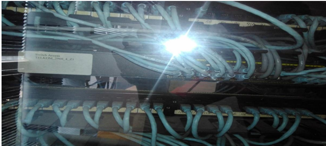
Gambar 3.4. Switch Layanan BPJS (Sumber: Dokumen Perusahaan PT.Infomedia Nusantara)
