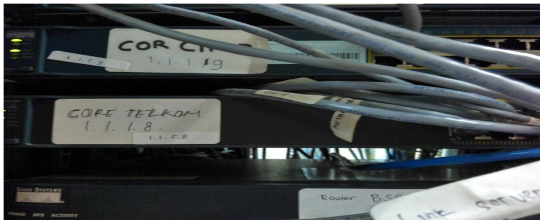
Gambar 3.5. Switch Core Infomedia Nusantara (Sumber: Dokumen Perusahaan PT.Infomedia Nusantara)
