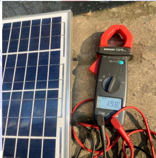
Gambar 4. 1 Foto Pengukuran Tegangan Panel Surya
