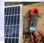
Gambar 4.1 Foto Pengukuran Tegangan Panel Surya
